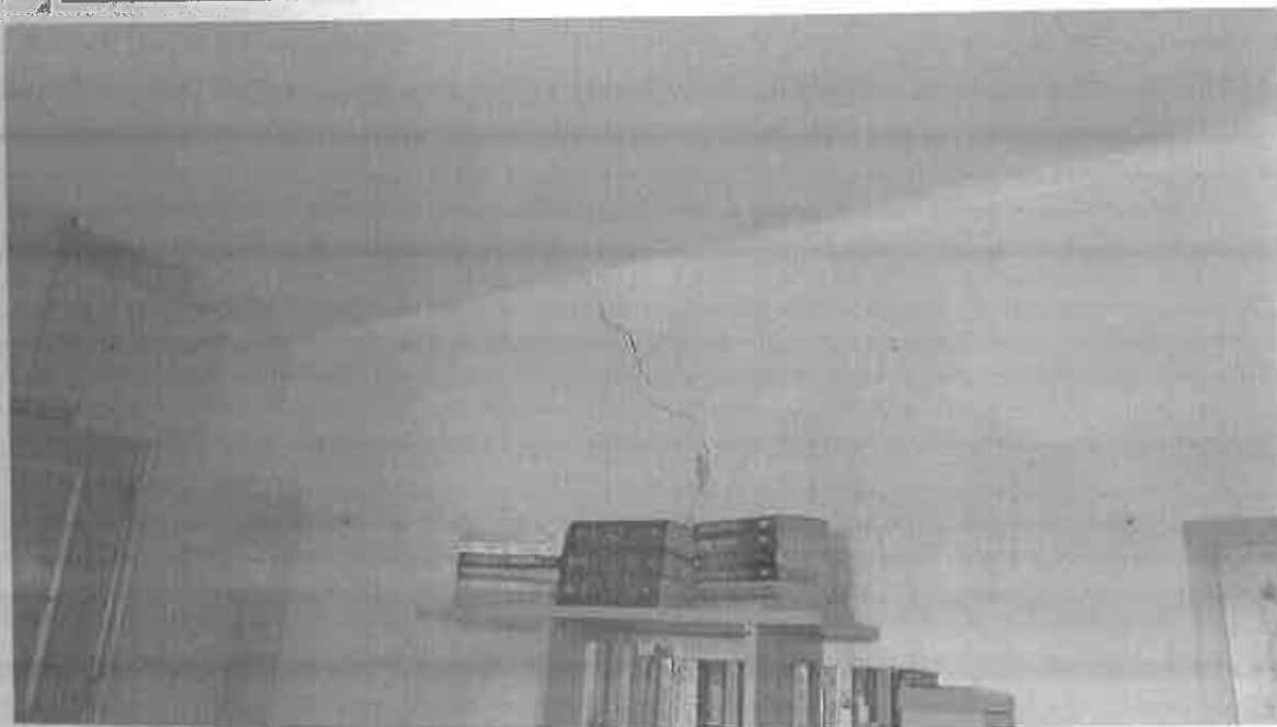
1. kép: Lakásban kialakult repedések
